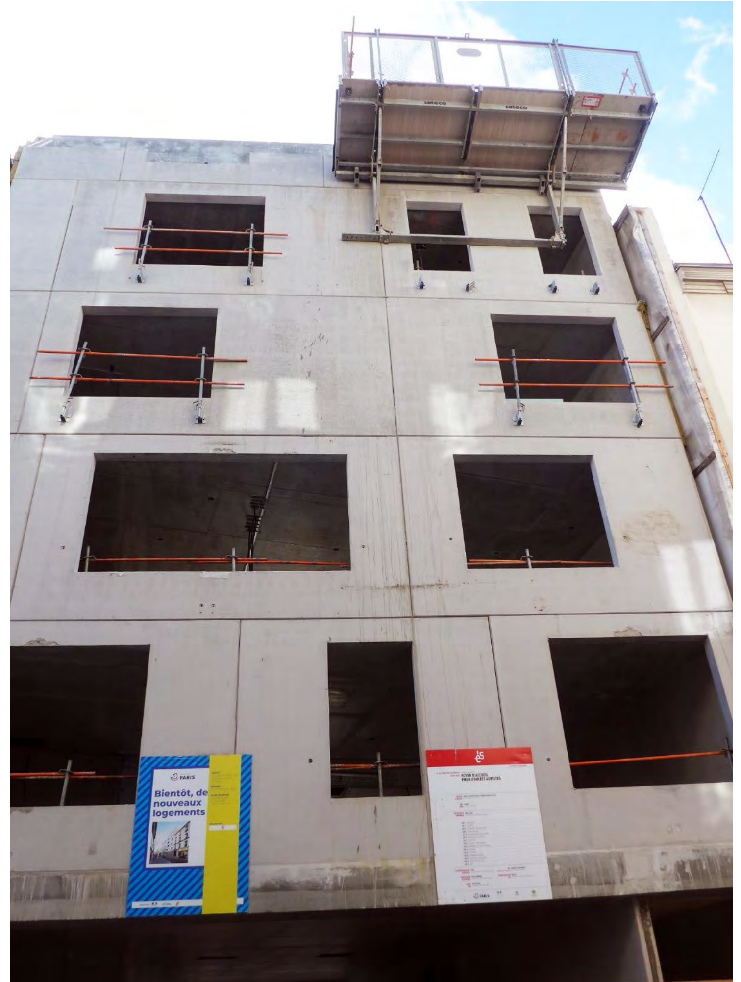
Façade sur rue réalisée en pré-murs pour limiter les interfaces avec la circulation
