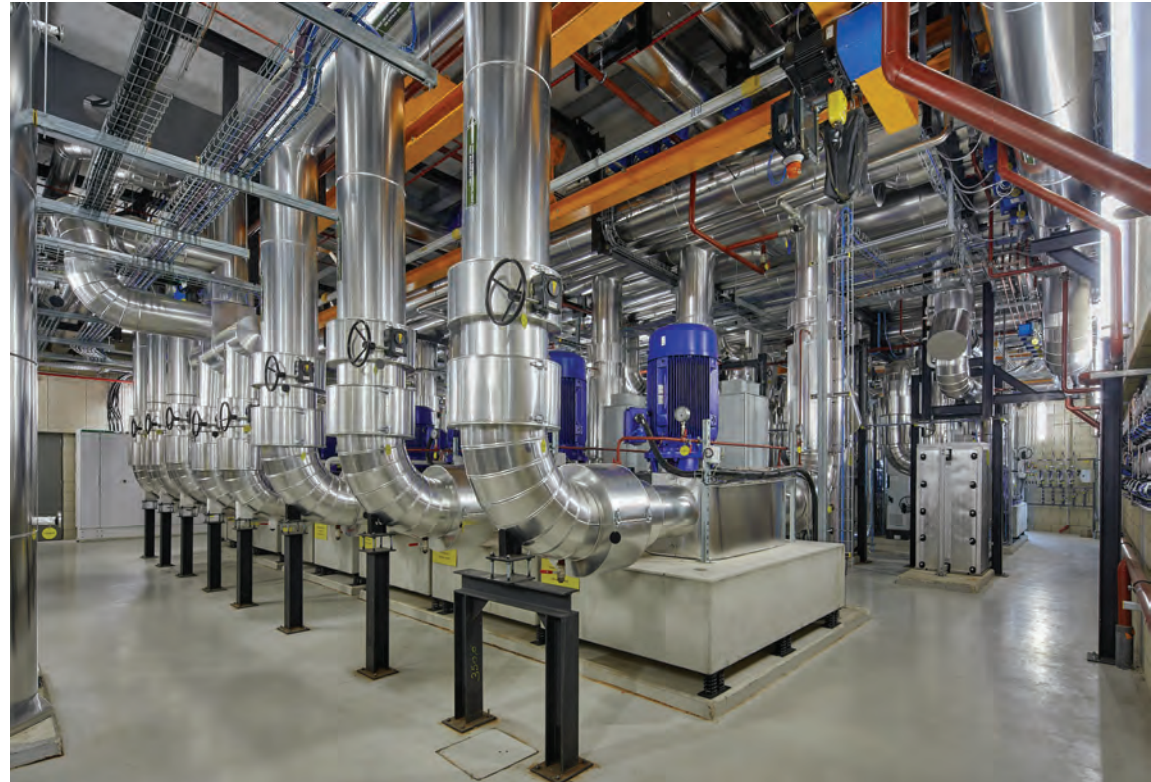
Salle des pompes et échangeurs équipée
