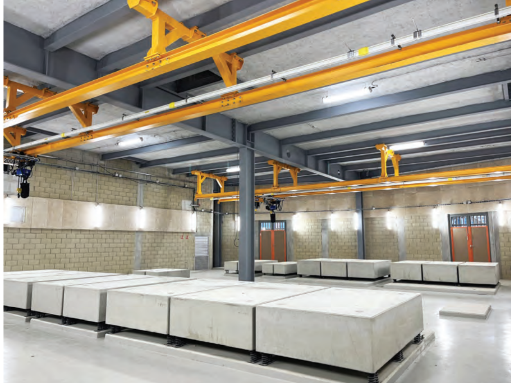
Salle des pompes et échangeurs avant la pose des équipements PROCESS sur les socles béton désolidarisés du dallage par des dispositifs anti-vibratiles.
