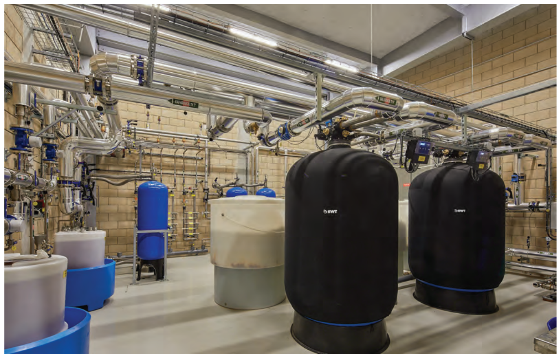
Local traitement d'eau
