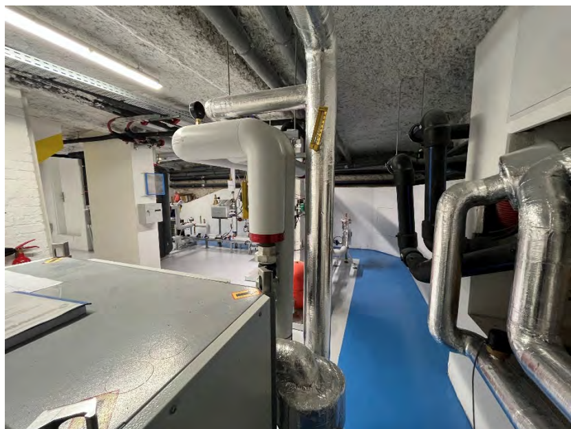
Local technique au sous-sol : Pompe à chaleur raccordée sur le réseau du Data Center contigu dans le cadre d'un partenariat
